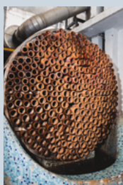
Una struttura in terracotta ad alveare è installata davanti ad una macchina che espelle calore di scarto in uno stabilimento di produzione della Deki electronics a Delhi. India, 2019
